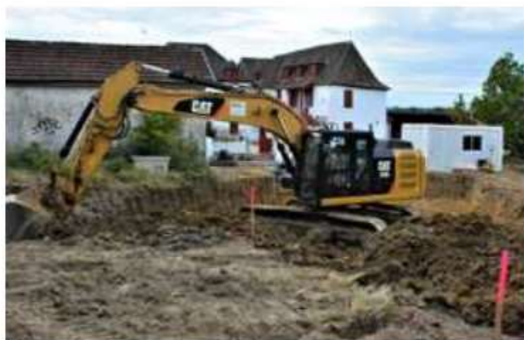
Les engins de chantier sont à pied d'œuvre à la côte Saint-Martin pour la réalisation du parking. © SERGE LAMELLE
