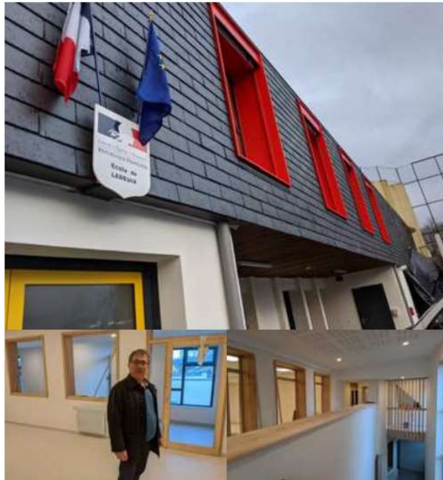
Les travaux de l'école de Ledeuix sont sur le point de se terminer. La façade est méconnaissable avec son 1 er étage recouvert d'ardoises. Bernard Aurisset s'engage à accueillir dès le 6 janvier 2020 les élèves au sein du bâtiment, dans lequel on retrouve beaucoup de bois pyrénéens. © GIL
