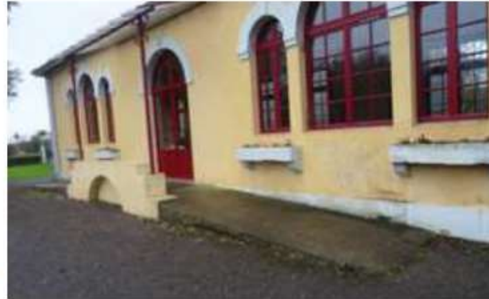
Les rampes d'accès seront à modifier. © ROGER CHAGLE
